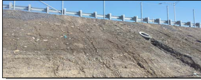
Accotement détérioré par l'eau.
